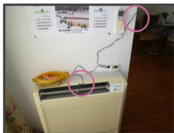
↑ エアコン吹き出し口
