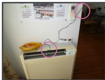
↑ エアコン吹き出し口
